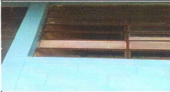
FOTO 1. SE PUEDE OBSERVAR QUE NO SE CUENTA CON BALCONES.
